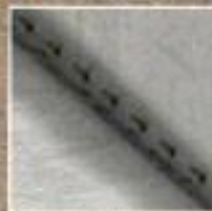
Lekkende aansluit- voegen
